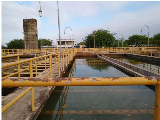
Depasa informou que técnicos tentam resolver problemas de vazamento na ETA II — Foto: Divulgação/Depasa/Arquivo
