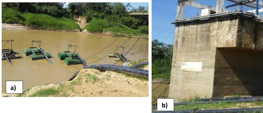
Figura 18 - Captação da Estação de Tratamento 2. a) Captação através de bombas flutuantes. b) Torre de tomada para captação desativada
