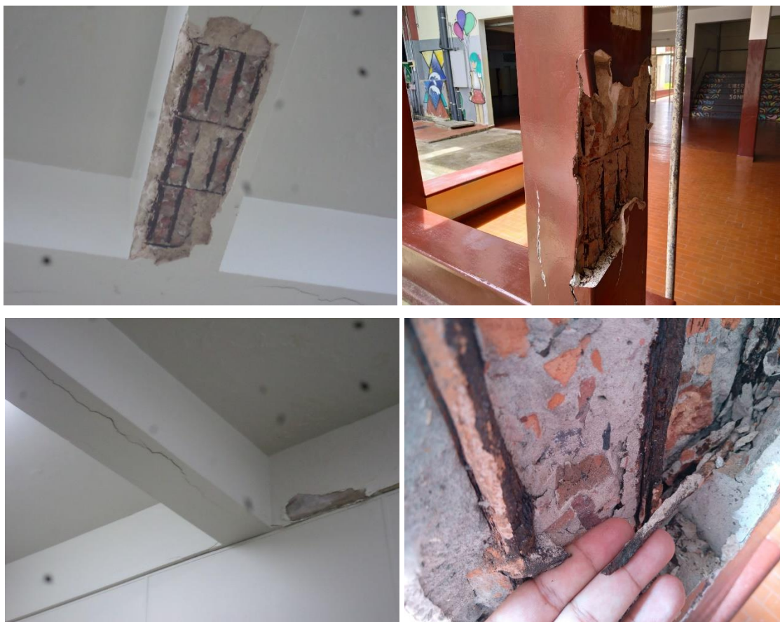
Figura 3 – Concreto com cacos de tijolos e armaduras expostas em vigas e pilares (direita)
