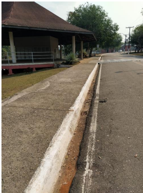
Figura 1 – Passeio existente em concreto com armação sem acabamento
