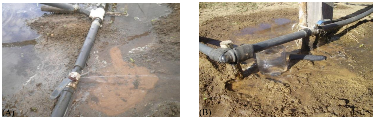
Figura 5. Vazamentos de água encontrados em sistemas de irrigação por gotejamento utilizados na comunidade “Pé da Terra” no município de Mâncio Lima/AC, 2013.
