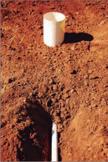
Figura 6 – Tubo de acesso para acionamento dos registros no início das linhas laterais
