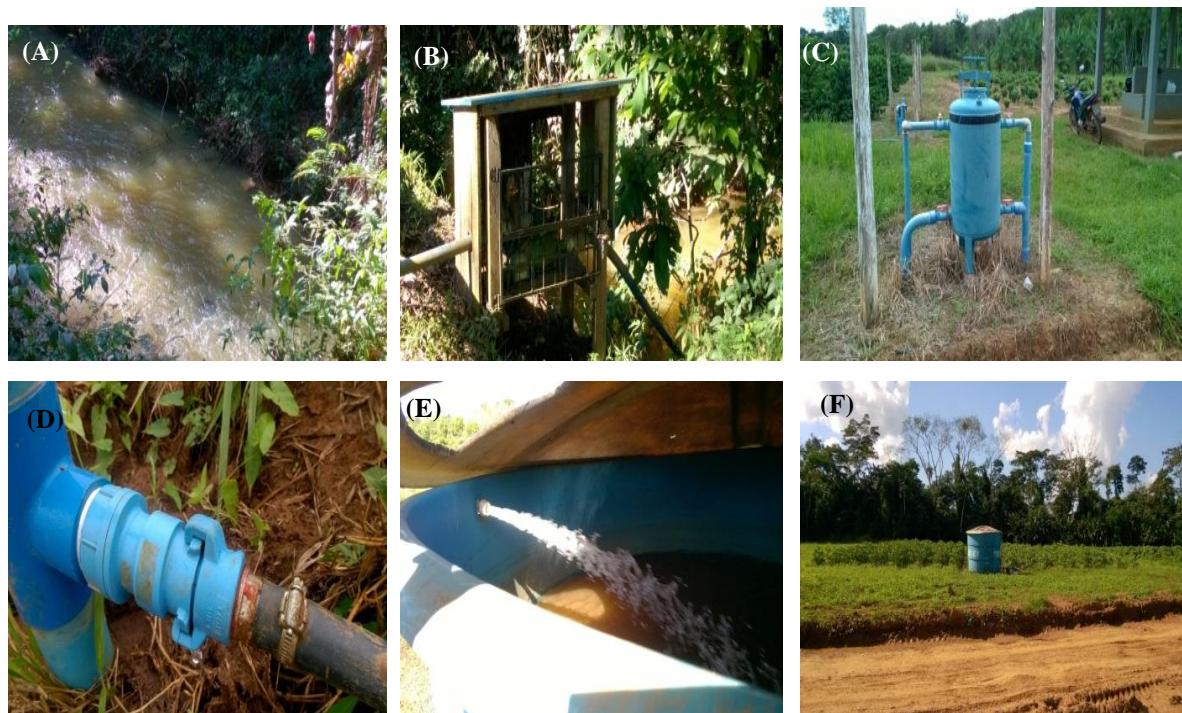
Figura 5. Vista do igarapé Quinari (A). Sistema de bombeamento de água do igarapé Quinari feito por um conjunto motobomba multiestágios de 7,5 CV, trifásico (B). Filtro metálico com núcleo interno de areia (C). Derivação da rede de água principal para o reservatório de água utilizado no experimento (D). Água sendo armazenada no reservatório de 10 m 3 (E). Vista frontal da área experimental (F). Embrapa Acre, Rio Branco/AC, 2015. Fonte: Leonardo Paula de Souza.
