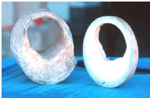
Figura 5.15 – Entupimento da tubulação por decantação de carbonato
