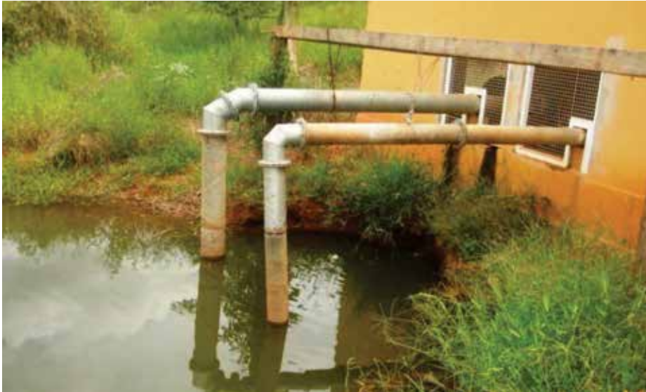
Figura 2.4 - Tubulações de sucção.
