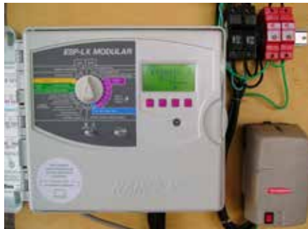
Figura 1.33 – Exemplo de painel de controle para automação.
