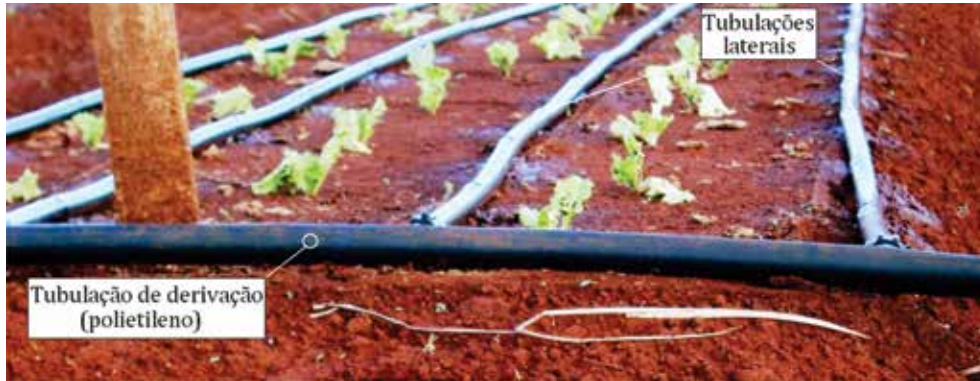
Figura 2.3 - Tubulação de derivação.
