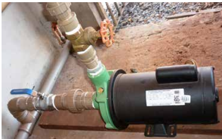
Figura 1.36 - Conjunto motobomba elétrico.
