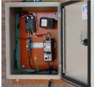
Figura 1.34 - Painel de acionamento.
