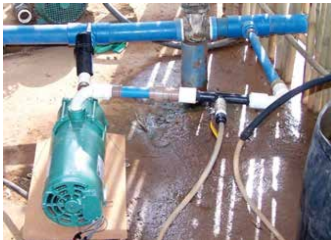
Figura 4.6 - Venturi em funcionamento com bomba auxiliar.
