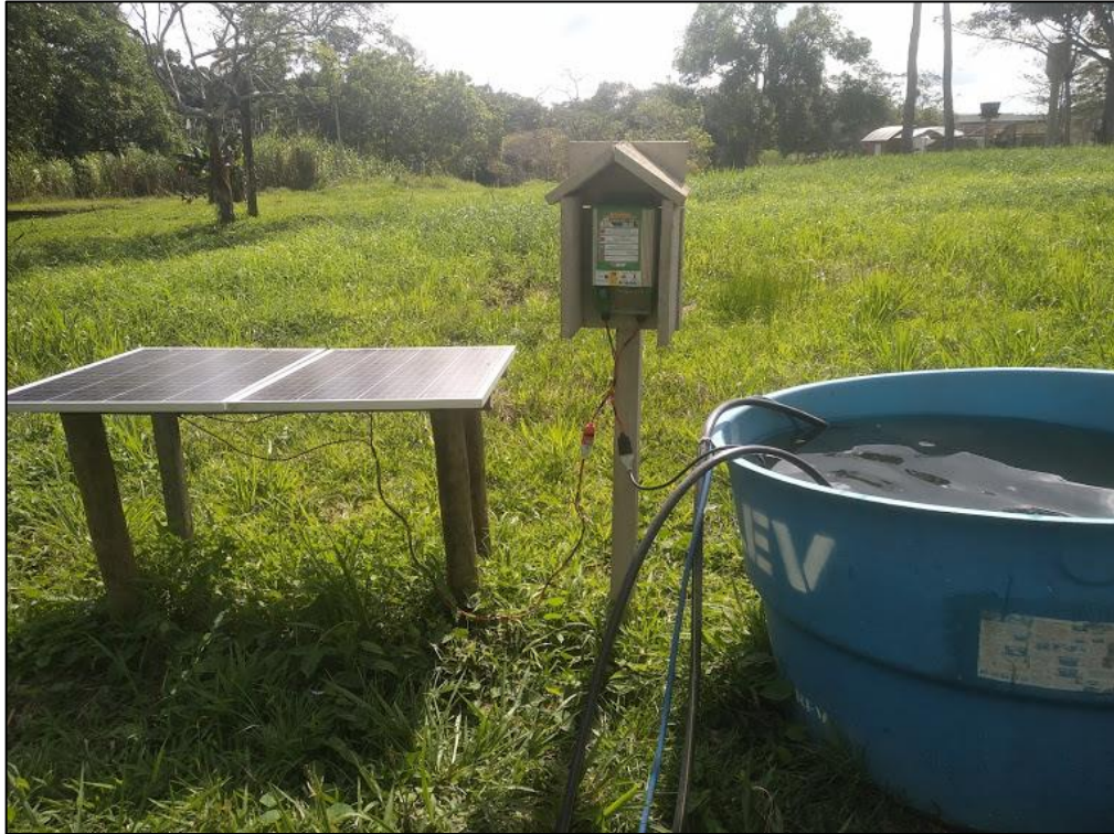
Figura 10 – Reservatório de água, Drive e Paineis solares, área de experimentação agrícola, Universidade Federal do Acre, Rio Branco, maio de 2020.
