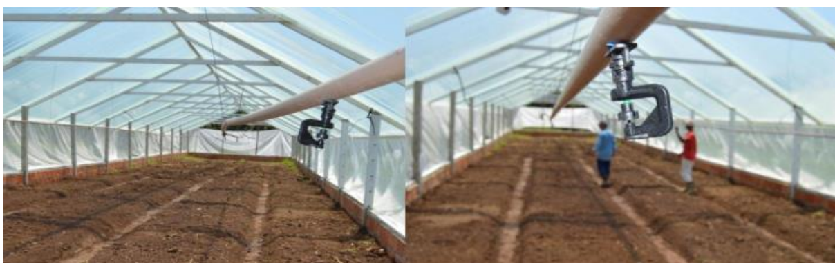
Figura 2 – Aspersores instalados utilizados na irrigação nas estufas. Foto: Geazí Penha Pinto, 2014.
